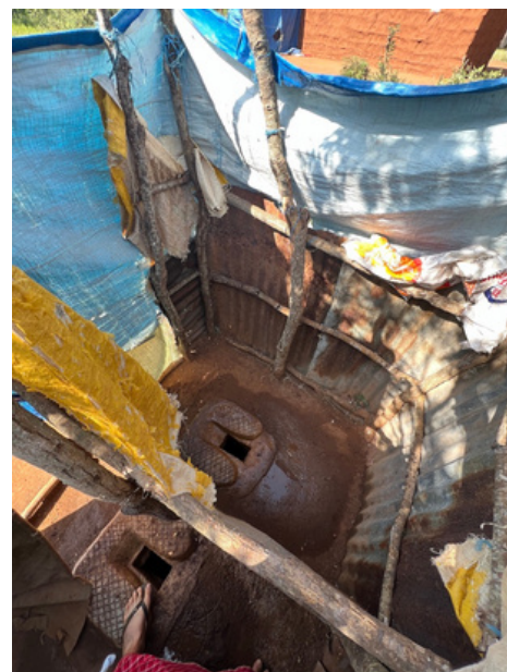
SALLE DE DOUCHE ET TOILETTES ACUELS
